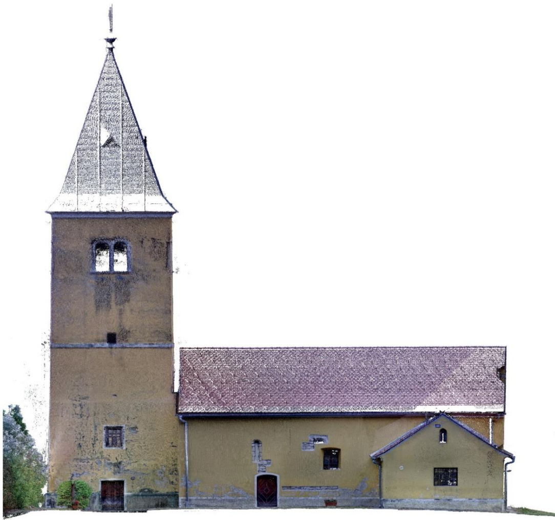
Slika 12. Južno pročelje- prikaz oštećenja pročelja
