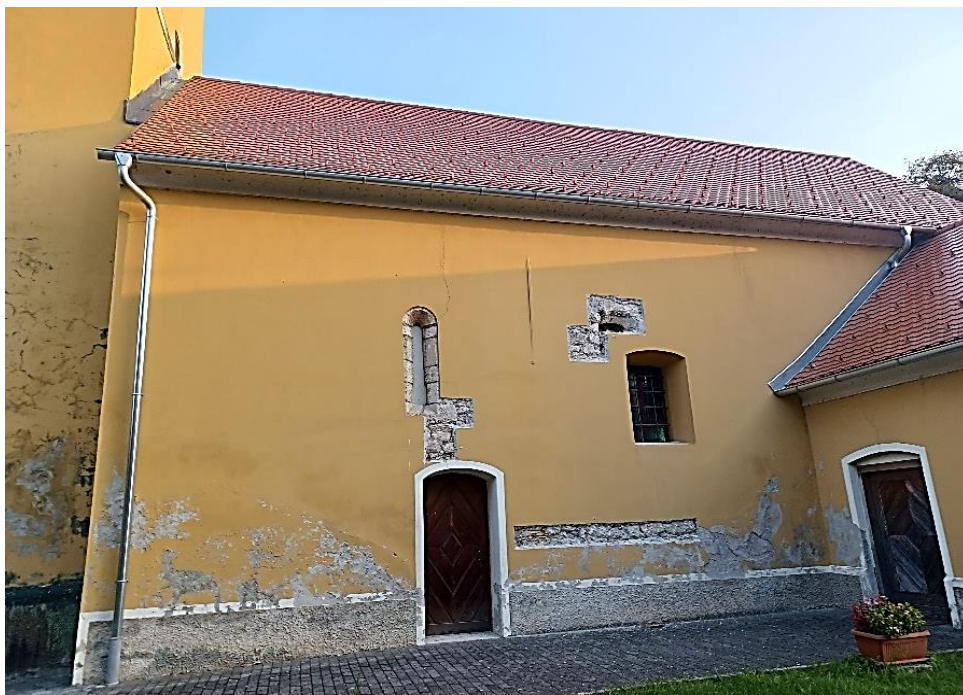
Slika 16. Prikaz oštećenja južnog pročelja
