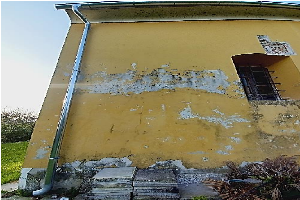
Slika 23. Prikaz oštećenja sjevernog pročelja
