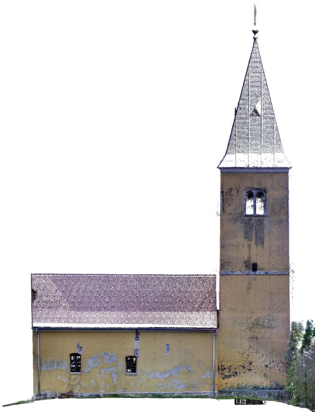
Slika 21. Sjeverno pročelje- prikaz oštećenja pročelja
