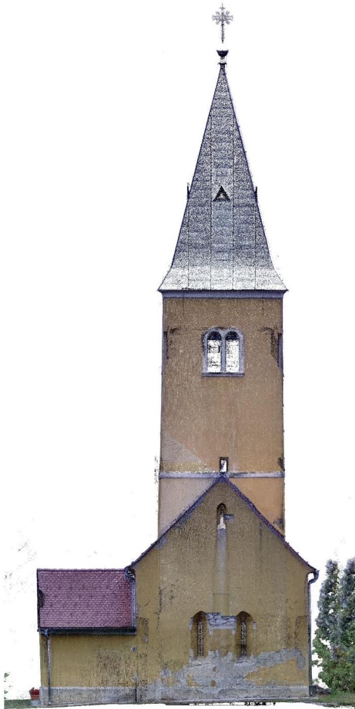
Slika 24. Istočno pročelje- prikaz oštećenja pročelja
