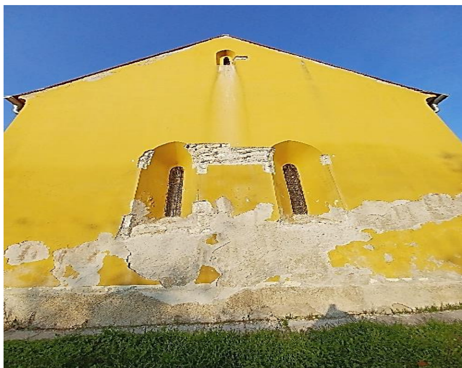
Slika 26. Prikaz oštećenja istočnog pročelja
