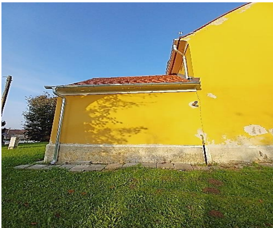
Slika 25. Prikaz oštećenja istočnog pročelja
