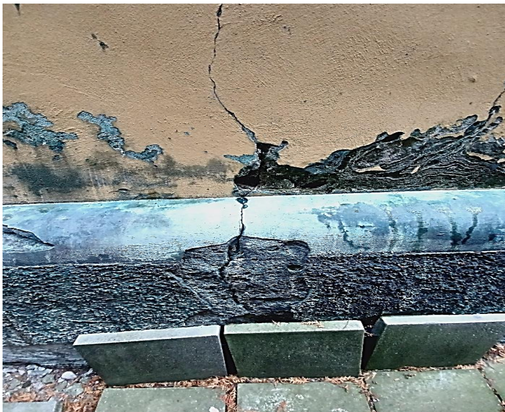
Slika 19. Prikaz oštećenja zapadnog pročelja
