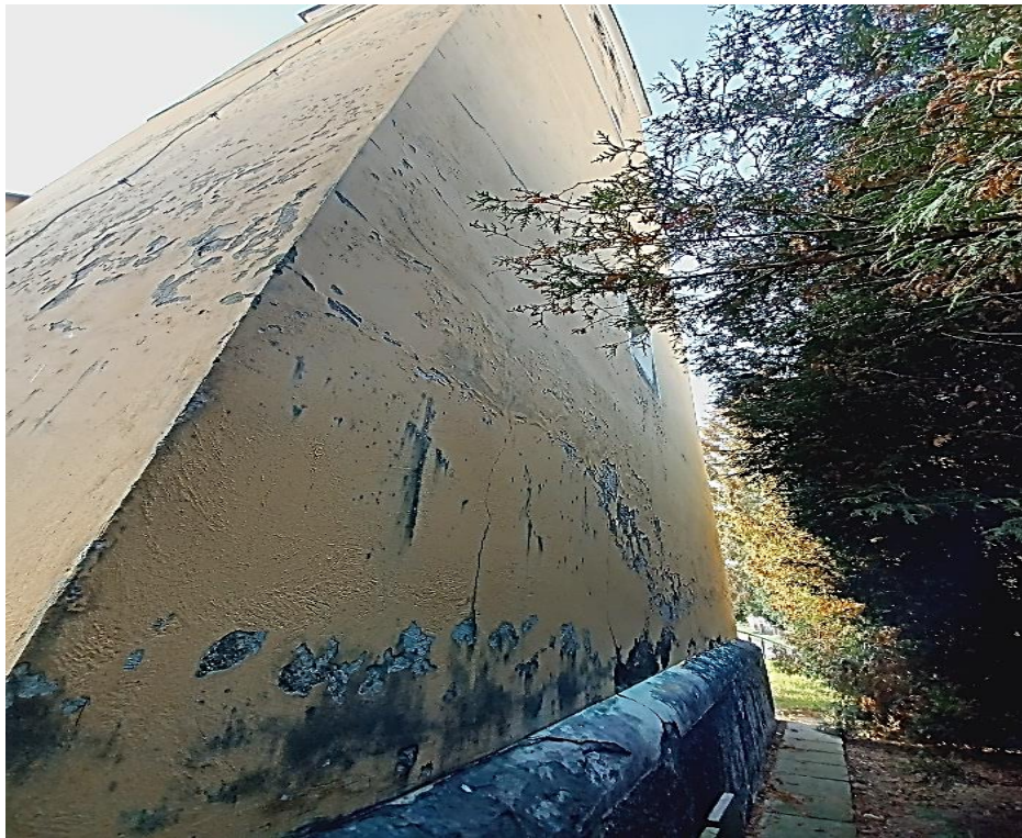
Slika 18. Prikaz oštećenja zapadnog pročelja
