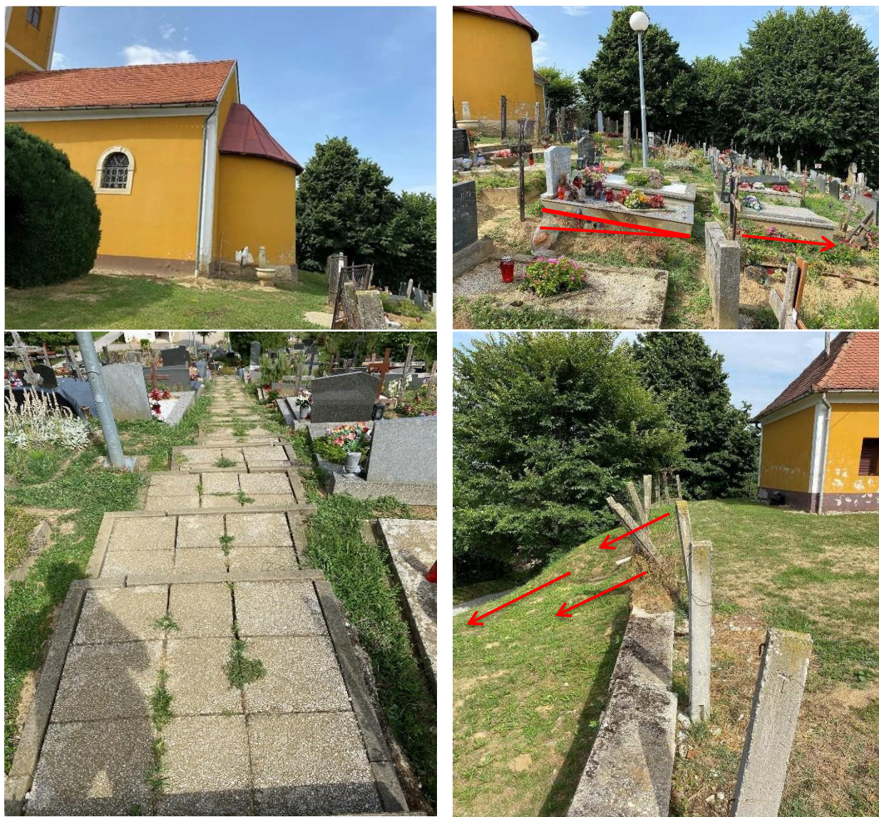
Slika 37. Jasno vidljivi znakovi padinskog puzanja sa istočne i sjeverne strane kapele. Ovdje je važno primjetiti neposrednu blizinu kapele kao i nagnute konstruktivne elemente koji upućuju na puzanje terena (stepenice, potporni zidovi, te stupovi ograde)
