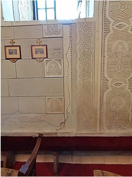
Slika 39. Oštećenje lijevog zida broda crkve
