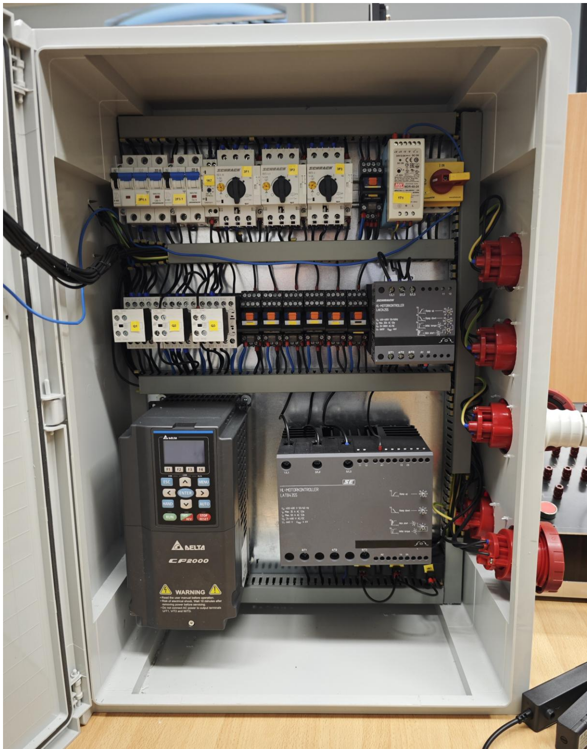
Slika 4.2 Izgled ispitne stanice sa ugrađenom upravljačkom opremom[1]
