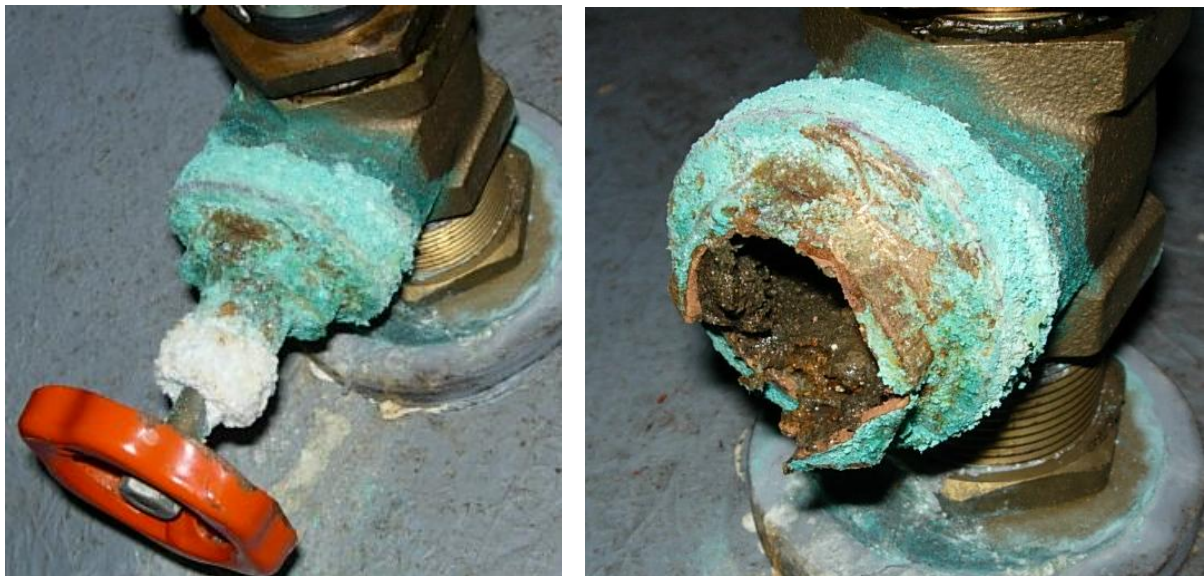
Slika 4.17 Uslijed decinkacije mjedi dolazi do puknuća ventila [31]
