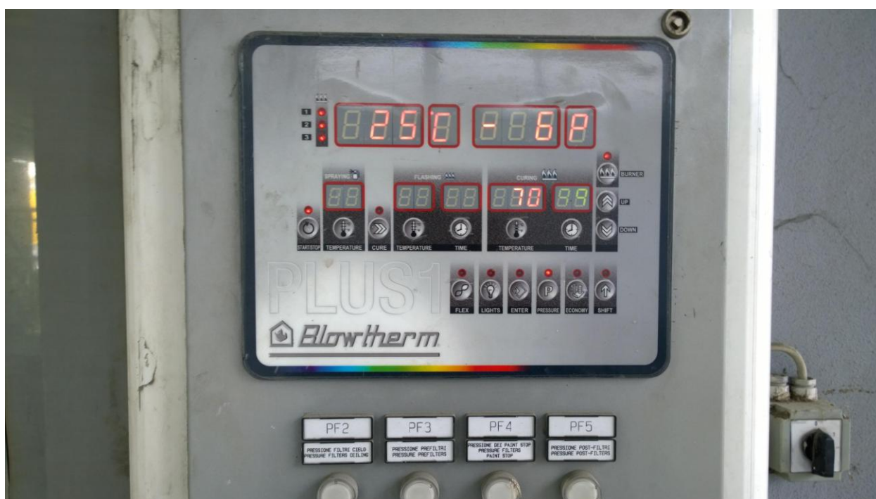
Slika 6.13 Postavljanje temperature za sušenje
