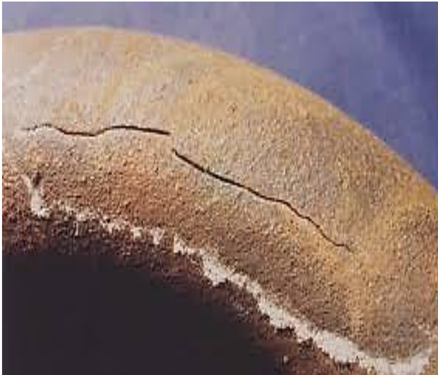
Slika 4.20 Primjer napetosne korozije ugljičnog čelika [34]
