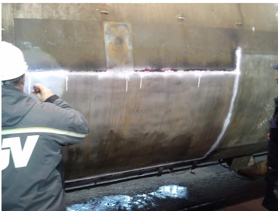
Slika 32. Pregled zavarenih spojeva nakon ispitivanja
