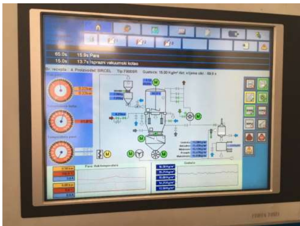
Slika 4.6 Modul za upravljanje predekspanderom
