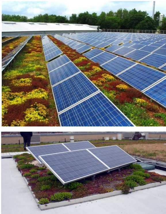
Slika 9.4.2.1. Fotonaponske ćelije na zelenom krovu
