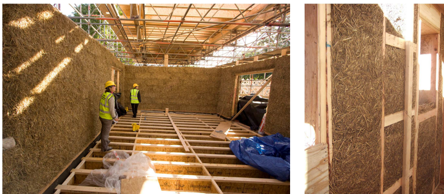
Slika 2.10 Slam kao toplinsko izolacijski materijal
