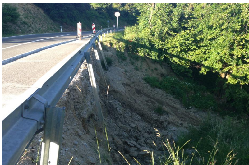
Slika 8.1 Državna cesta D22 – klizište „D22- Sudovec II.“
