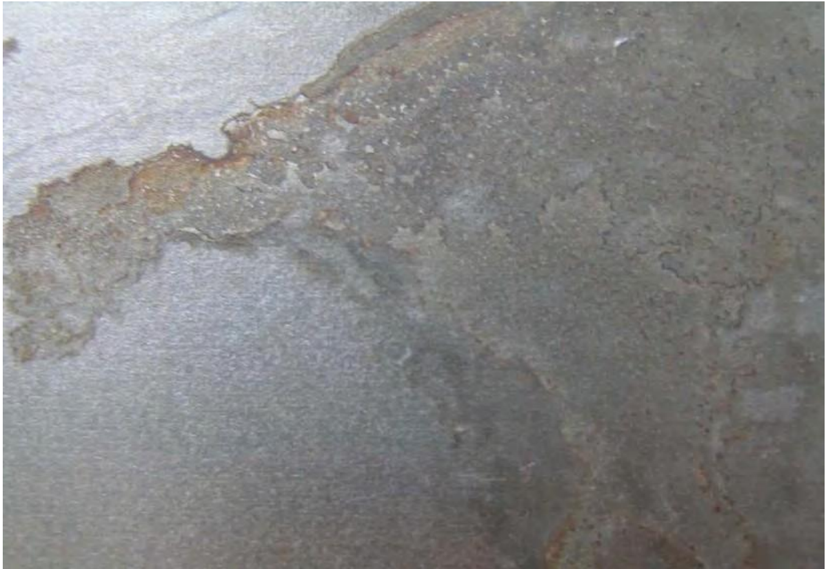
Slika 33 - Početna neobrađena korozija čeličnog lima
