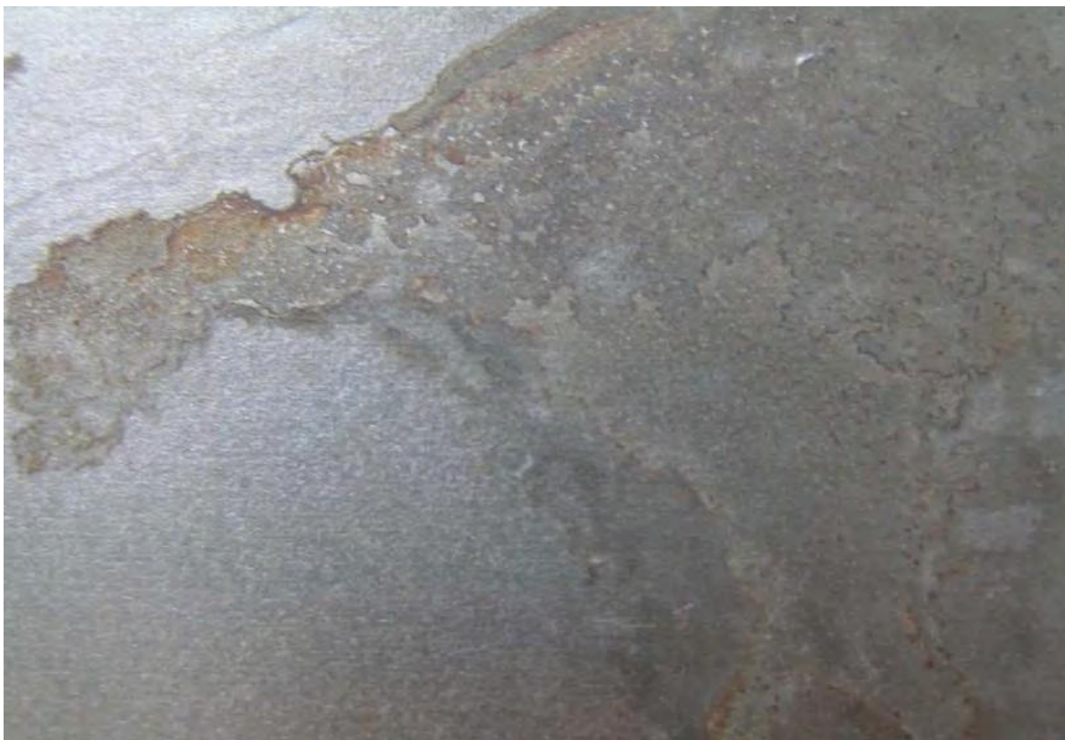
Slika 33 - Početna neobrađena korozija čeličnog lima
