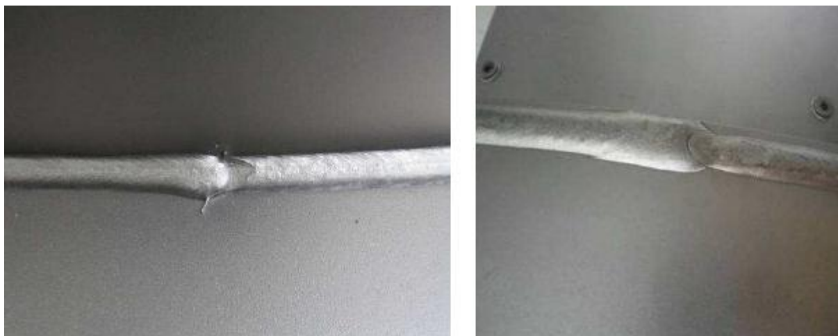
Slika 2.24 Nepravilno izveden nastavak zavora (517) [13]
