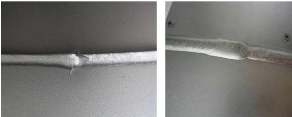
Slika 2.24 Nepravilno izveden nastavak zavara (517) [13]
