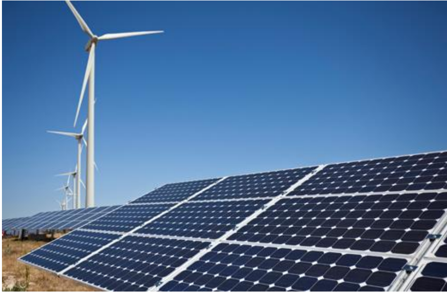
Slika 3.3.2. Vjetrogeneratori i fotonaponski paneli
