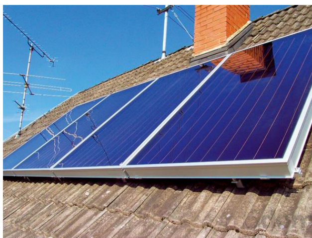
Slika 3.1.5. Solarni kolektori na krovu
