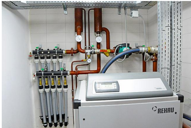
Slika 3.1.9. Geotermalna toplinska pumpa
