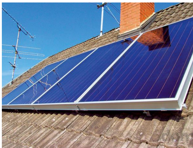
Slika 3.1.5. Solarni kolektori na krovu
