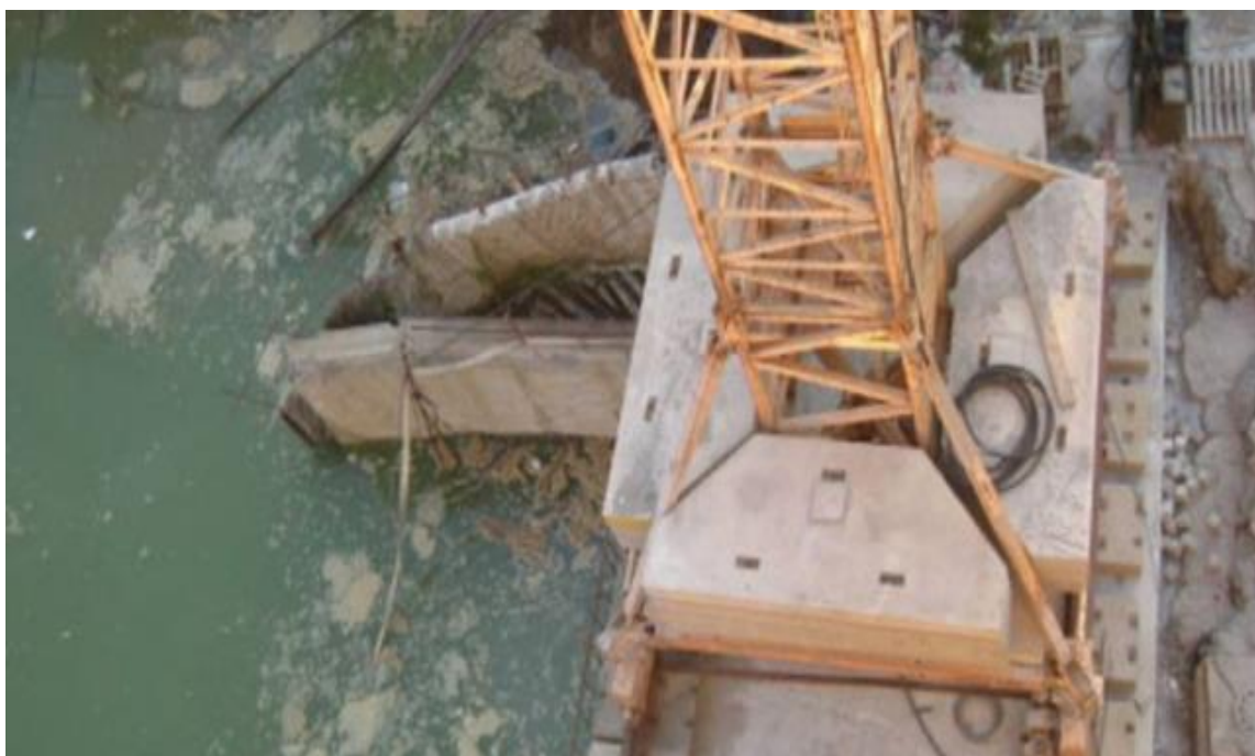
Slika 16. Urušavanje objekata i građevinske jame
