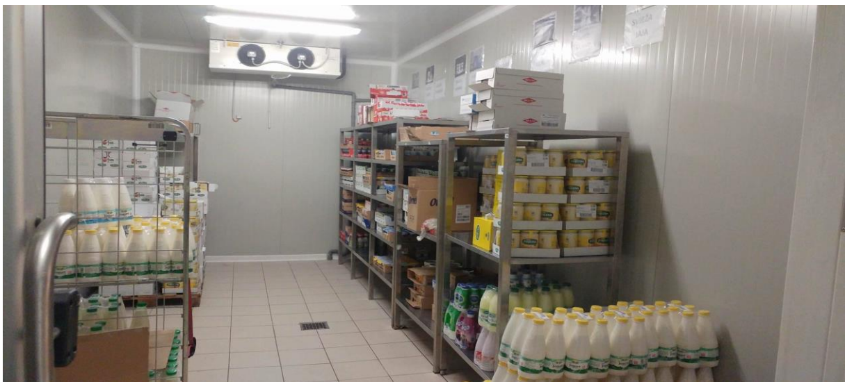
Slika 5.5. Rashladna komora poslovnice Super konzum Ivanec
