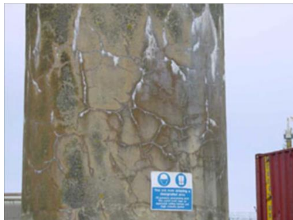
Slika 3.4. Primjeri oštećenja prilikom alkalno – silikatne reakcije
