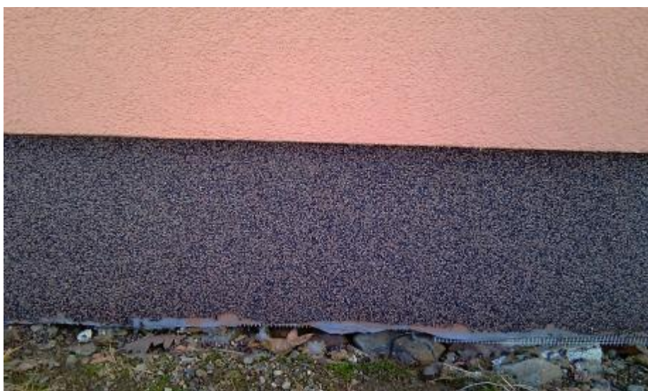
Slika 8. Sokl sa mozaik žbukom
