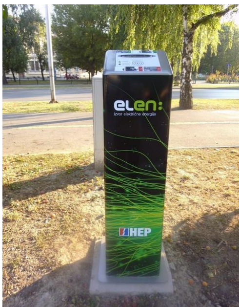
Slika 2.2. Izgled punionice električnih vozila smještene na javnoj površini [2]
