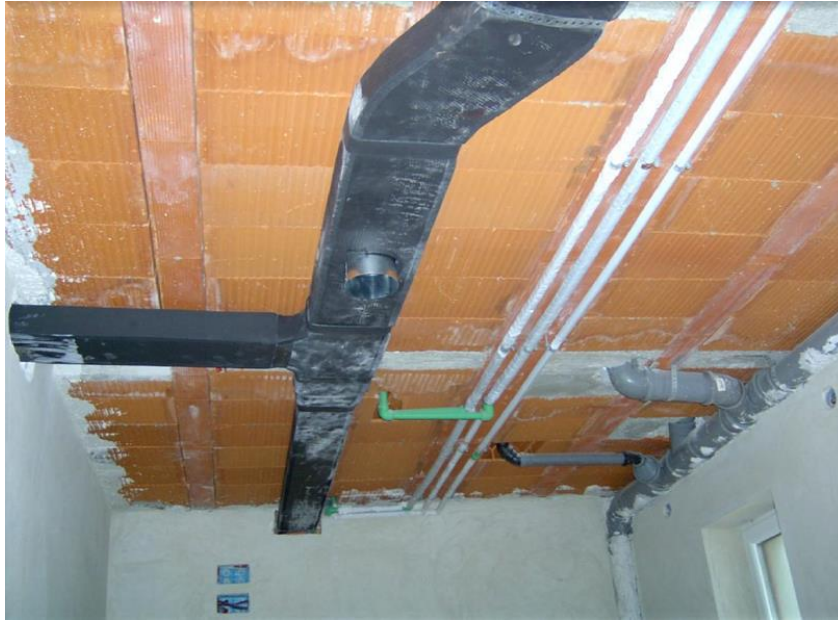
Slika 4.4.3.1. Ventilacijski razvod u pasivnoj kući
