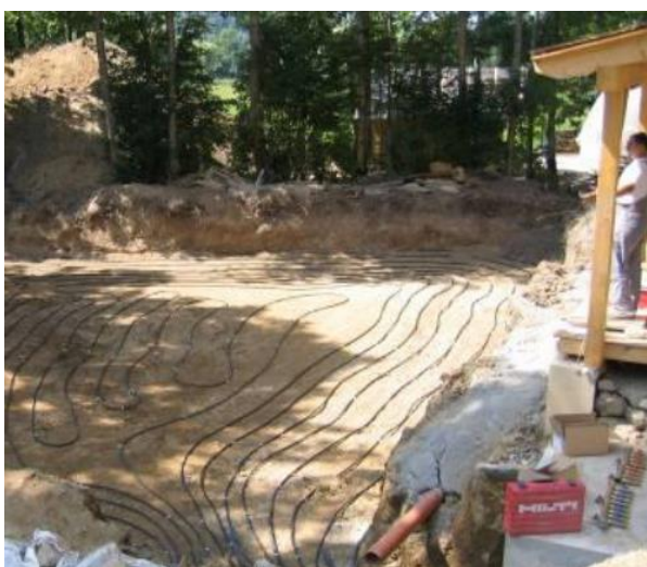
Slika 4.4.2.1. Zemni kolektor pasivne kuće u Begovom Razdolju (2007)
