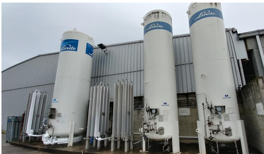
Slika 25. Vanjski spremnici tehničkih plinova
