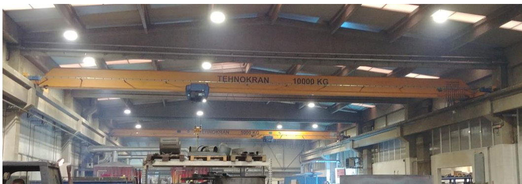
Slika 4. Kranovi u zavarivačkoj radionici
