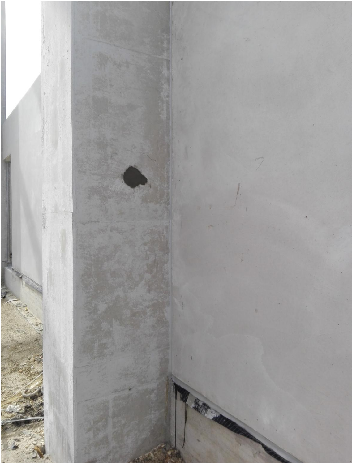
Slika 4.21. Zabetonirani otvor na AB stupu koji se koristio kod utovara i istovara AB elementa
