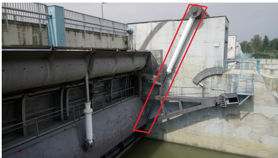
Slika 2.7. Preljevno polje, Servomotor segmentnog zatvarača
