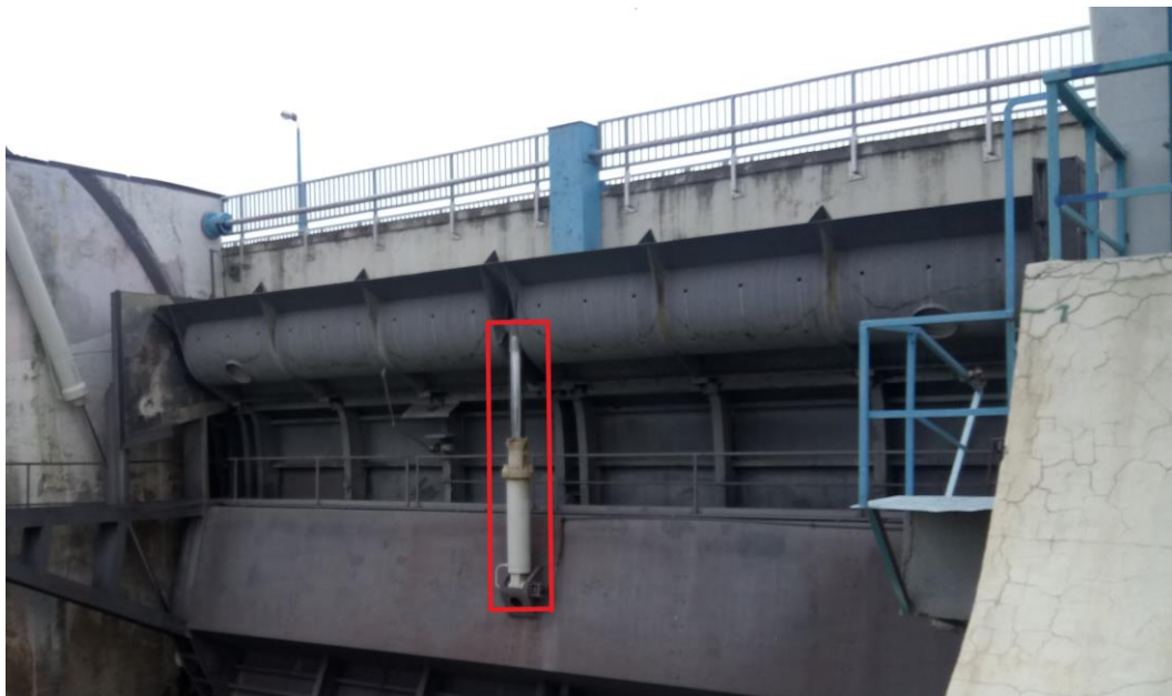
Slika 2.8. Preljevno polje, Servomotor zaklopke
