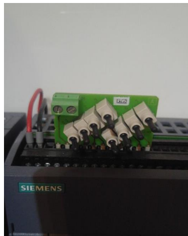
Slika 5.22 Digitalni ulazi PLC-a
