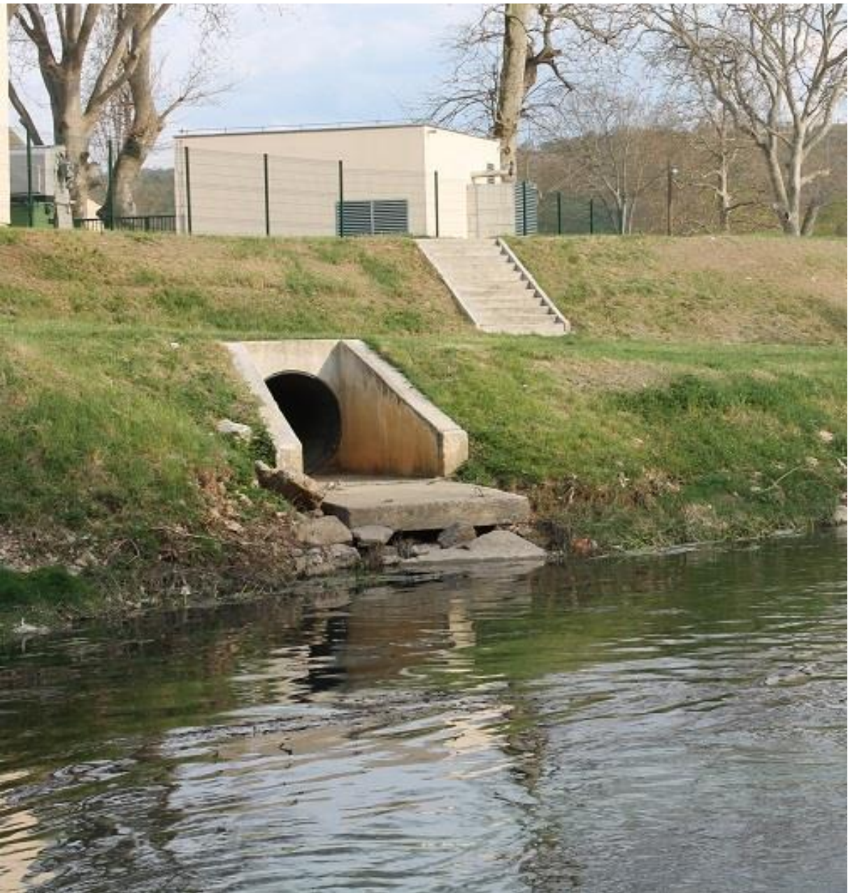
Slika 3.4.2.: Ispust u rijeku Krapinu
