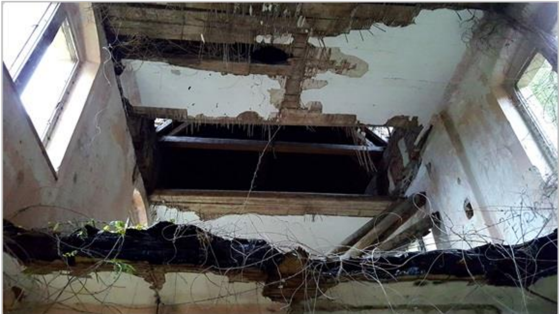
Slika 5.3. Spaljeni stropovi u dvorcu Opeka
