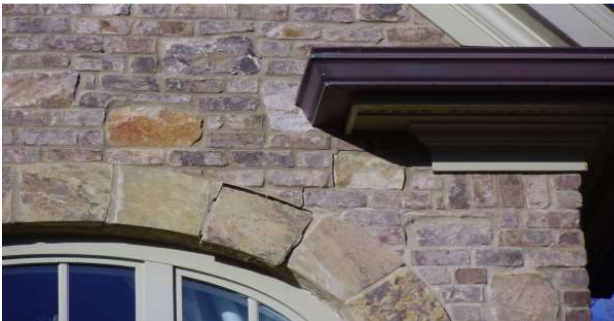
Slika 14. Pojava pukotina na kamenoj fasadi
