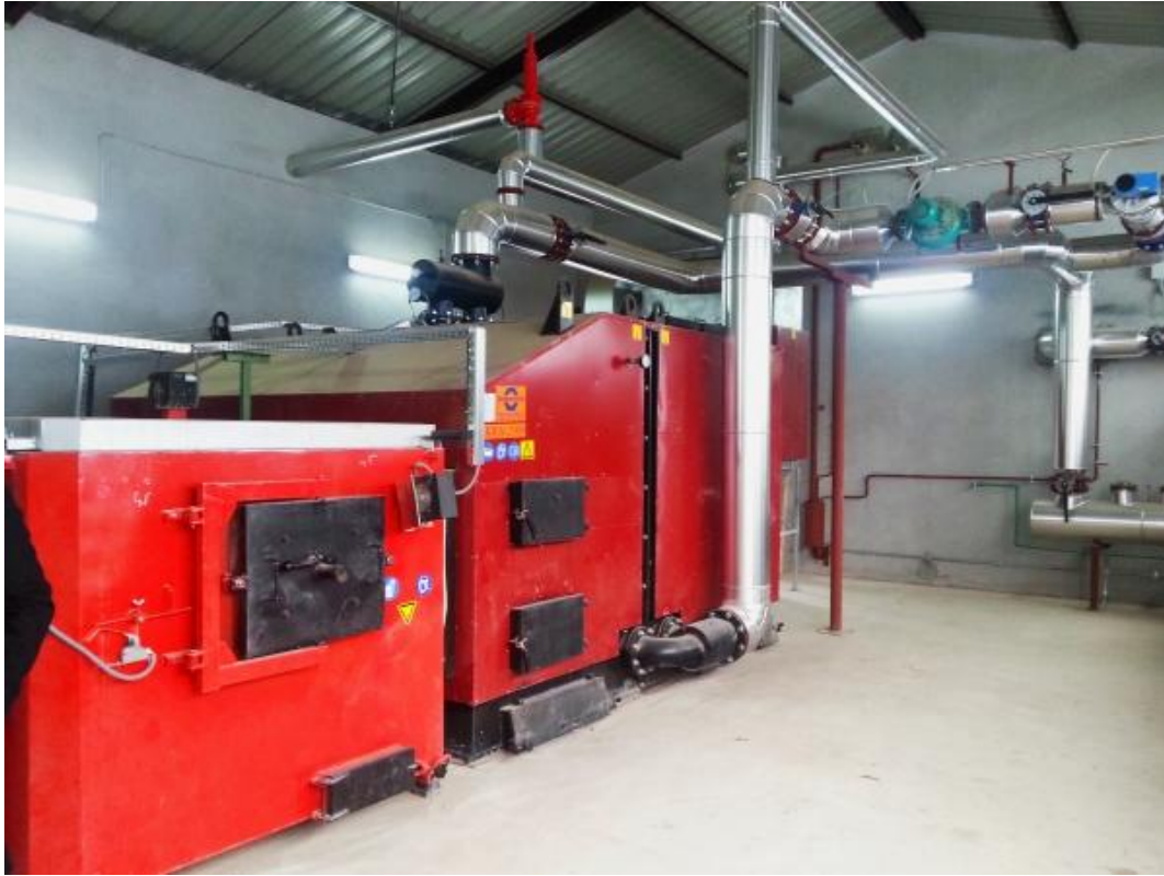
Slika 3.2 Toplovodni kotao KWH-1000 [7]
