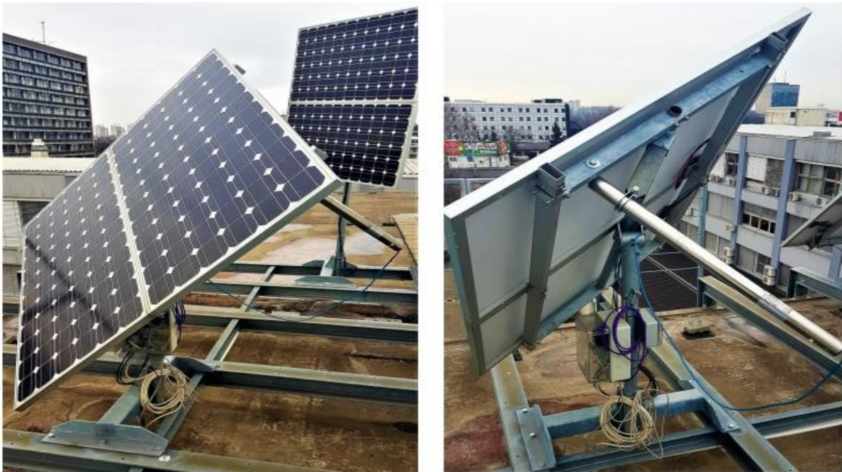
Slika 5.8. Solarni paneli na jednoosnom nosaču [52]
