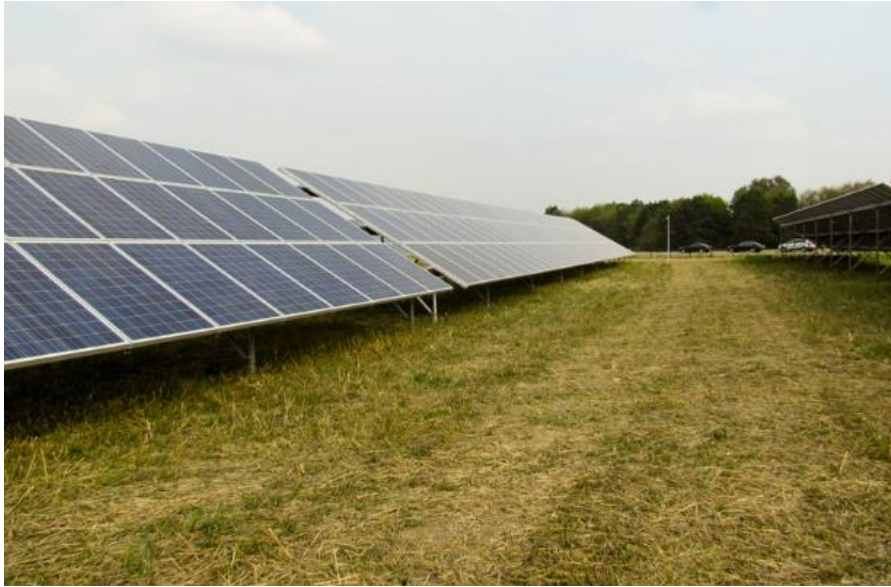
Slika 5.3. Fotonaponska elektrana FNE Orahovica 1 [13]
