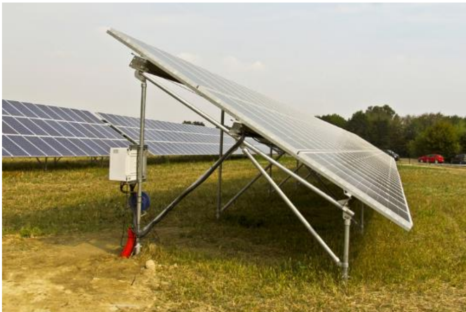
Slika 5.4. Fotonaponska elektrana FNE Orahovica 1 [13]
