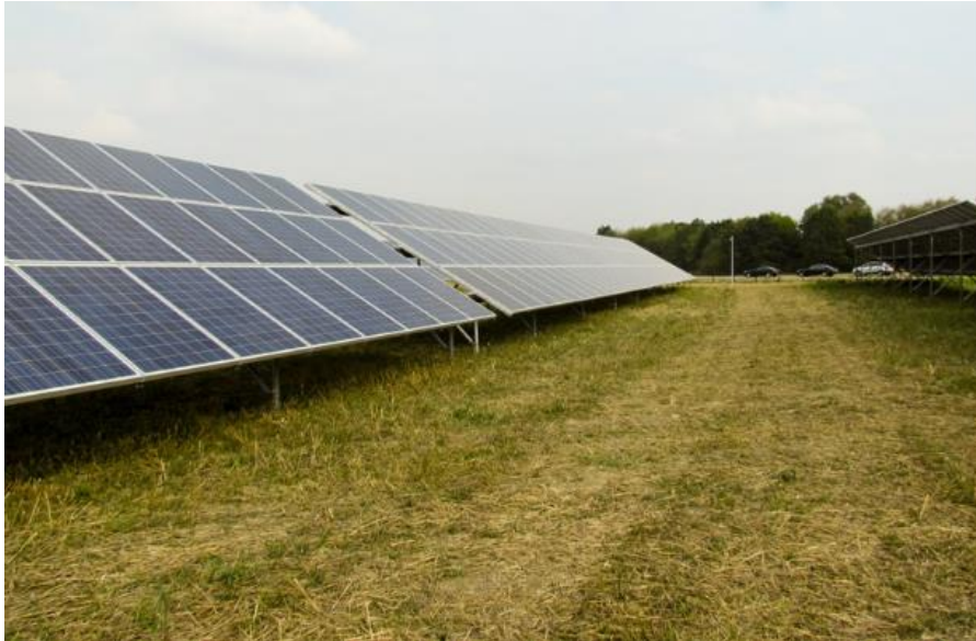
Slika 5.3. Fotonaponska elektrana FNE Orahovica 1 [13]
