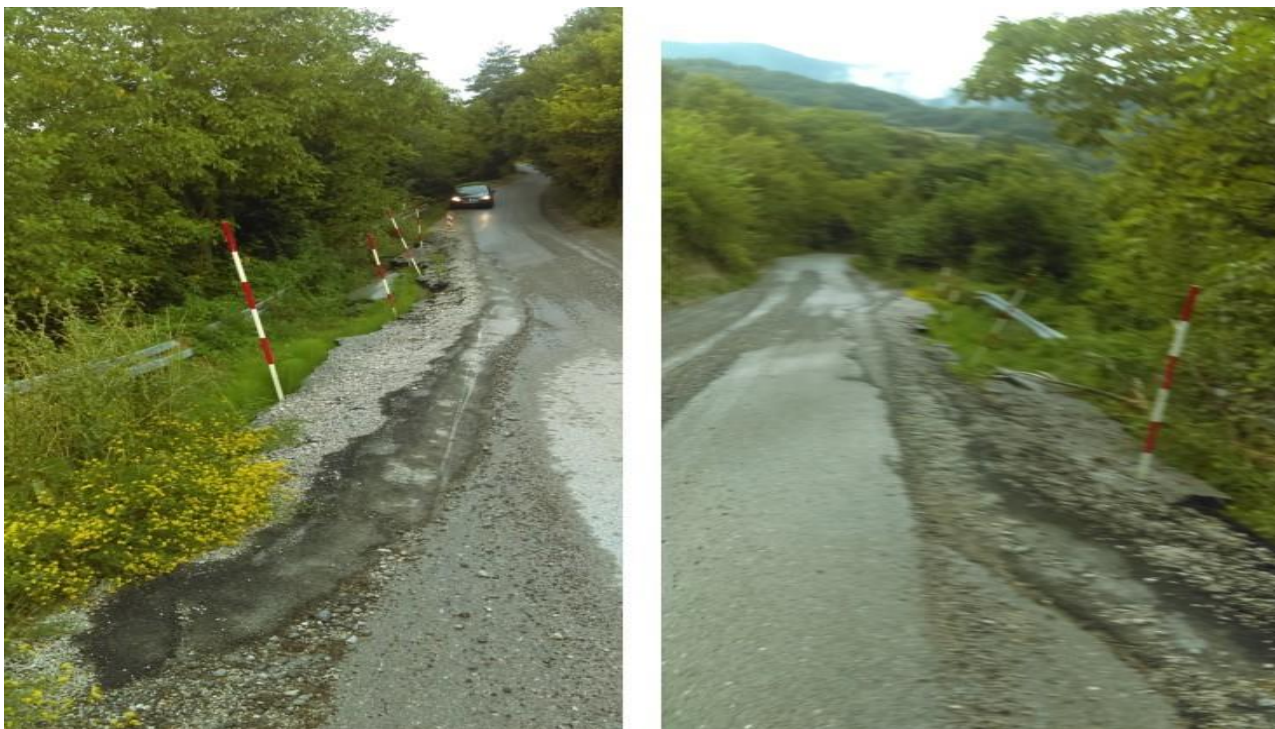
Slika 12. Klizište u Vranov Dolu
