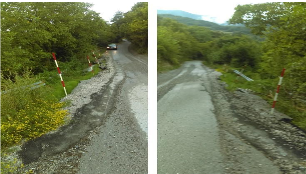
Slika 12. Klizište u Vranov Dolu
