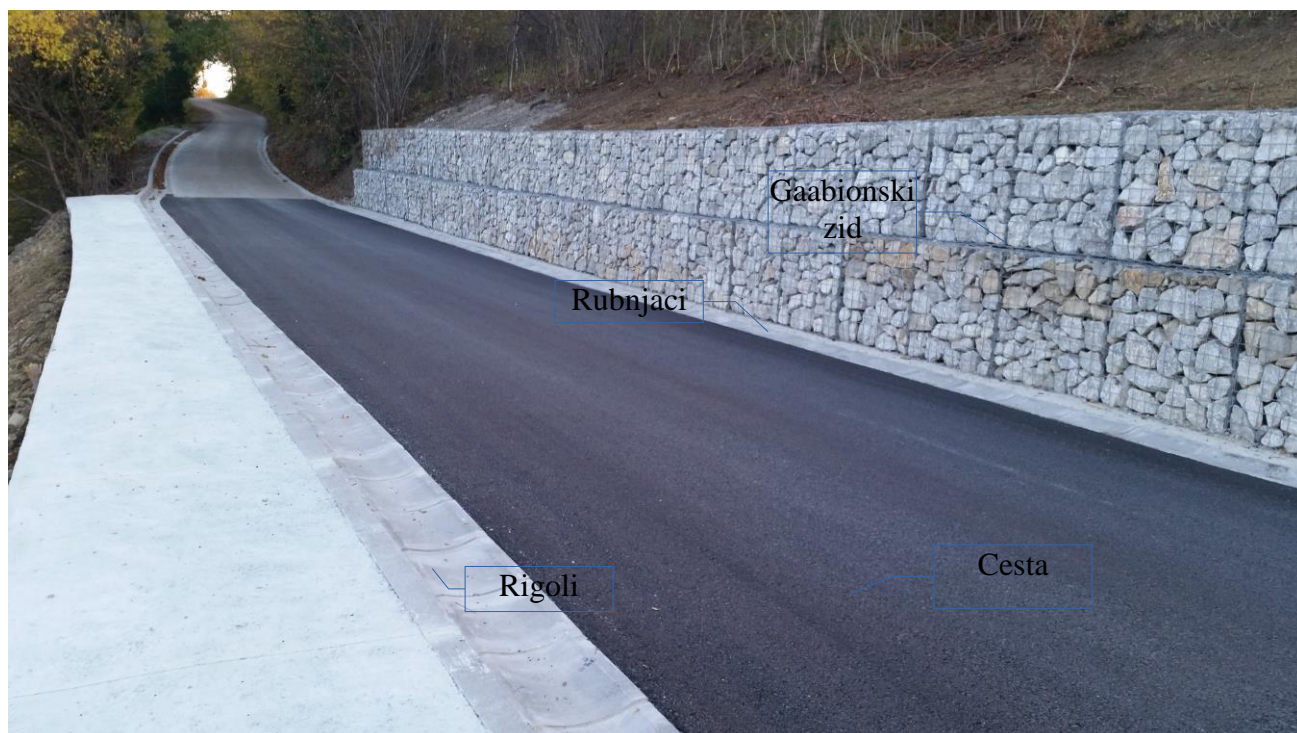
Slika 26. Izvedbeni gabionski zid ispod (preko kojeg je betonirana AB ploča) i iznad ceste
