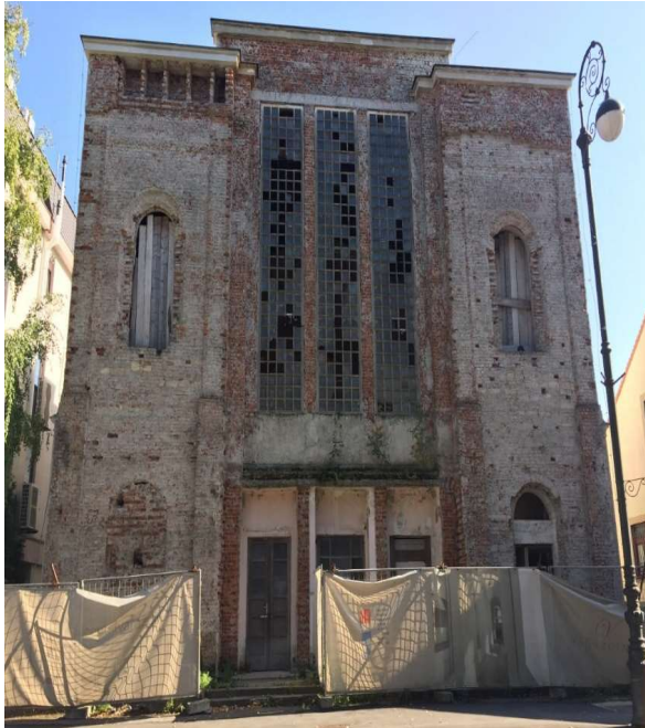
Slika 3.5. Fotografija devastiranog pročelja varaždinske sinagoge u ulici Augusta Cesarca 16a. Fotografirala: Ana Bašić
