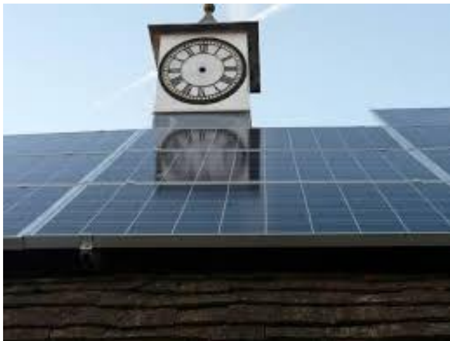
Slika 6. Zasjenjje fotonaponskih modula stranim tijelom [7]
