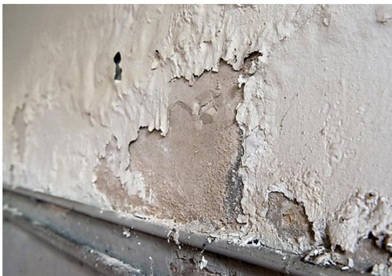
Slika 22. Oštećenje žbuke uzrokovano vlagom
