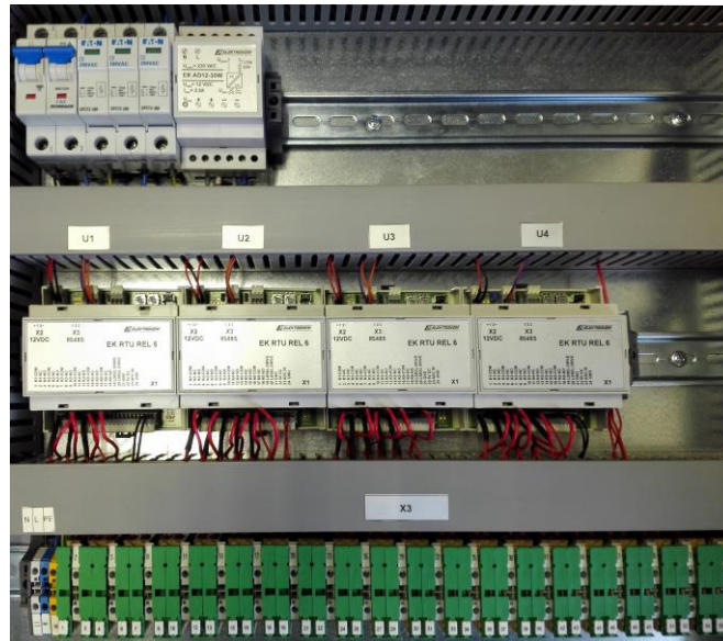
Slika 3.3. Izgled upravljačkog ormara iznutra
