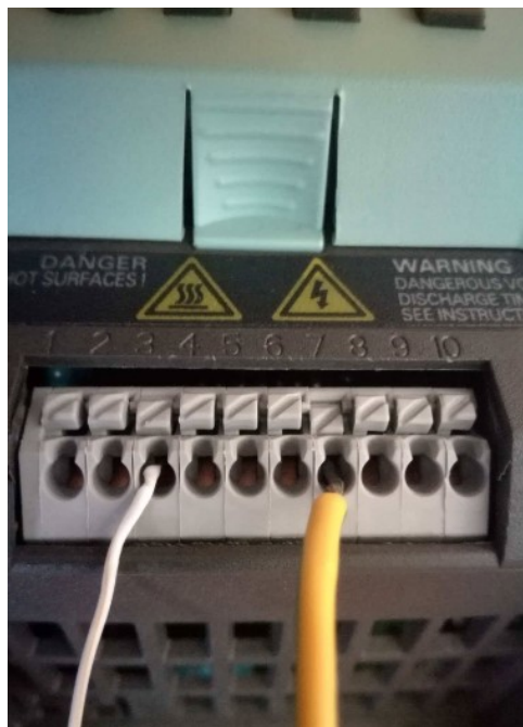
Slika 7.1 Korišteni terminali frekvencijskog pretvarača prema PLC-u
