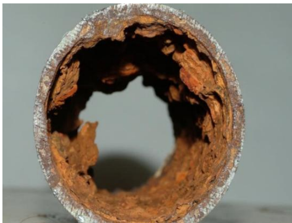
Slika 2. Kemijska korozija u ispušnoj cijevi [44]
