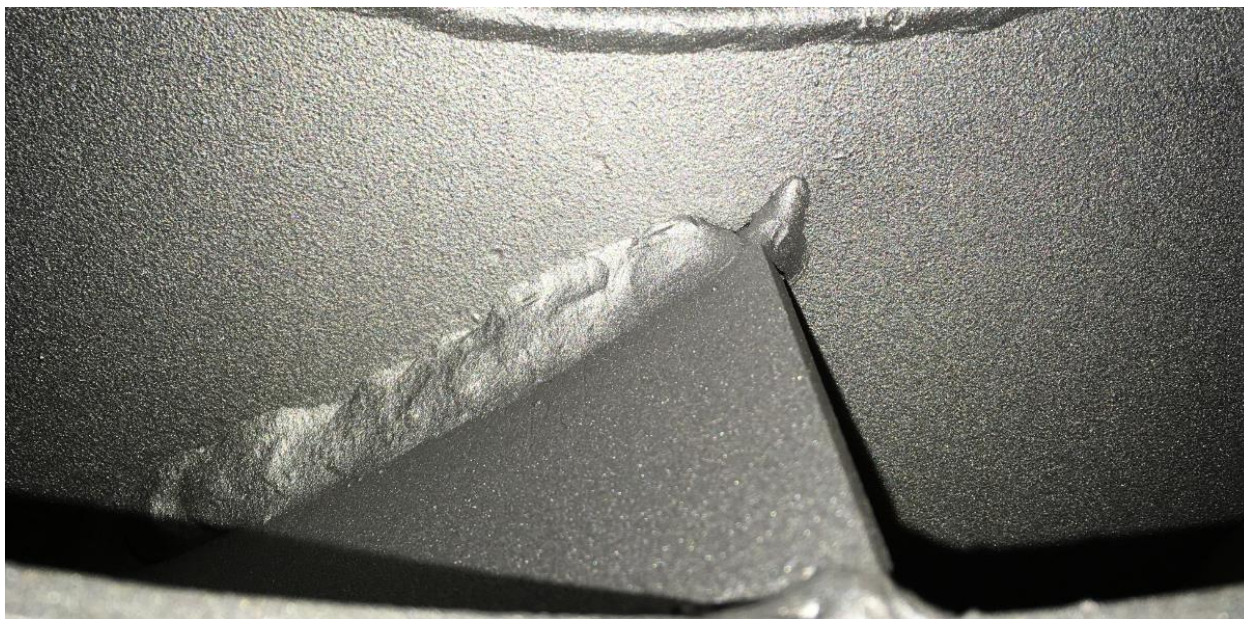
Slika 14: Pogreška oblika zavara zbog loše tehnike zavarivanja
