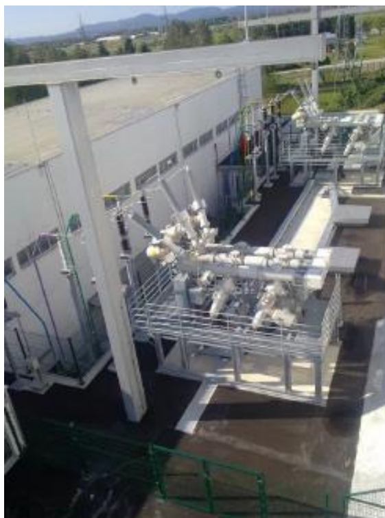
Slika 3.4. Postojeće rasklopno postrojenje 110 kV [2]
