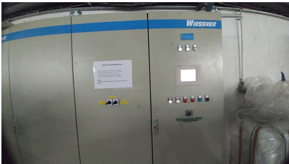
Slika 5.1. Upravljački ormar filtera
