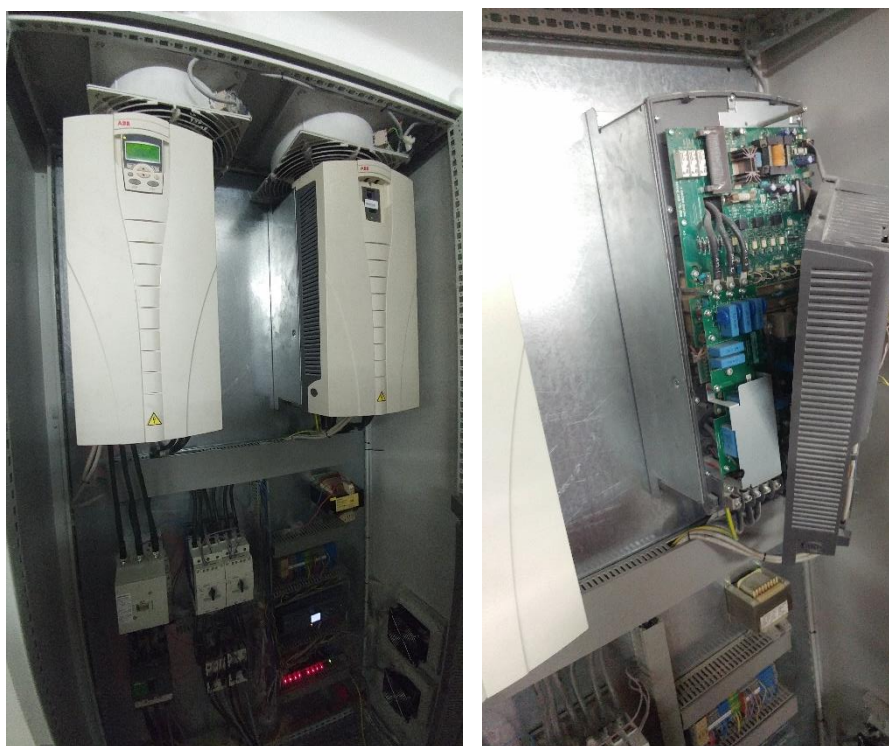
Slika 4.9. Prikaz frekvencijskih pretvarača u elektro ormaru te skidanje poklopca
