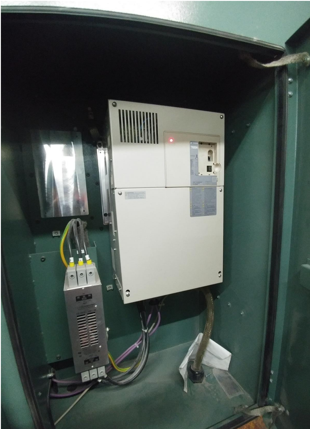
Slika 6.4. Elektro ormar sa frekvencijskim pretvaračem
