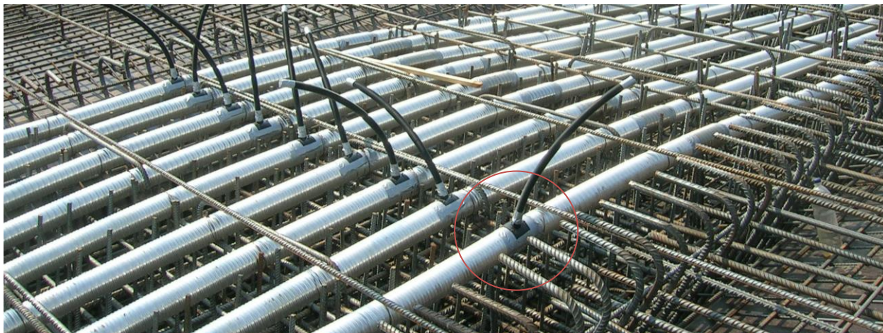
Slika 2.6 Kontrolne cijevi za odzračivanje
