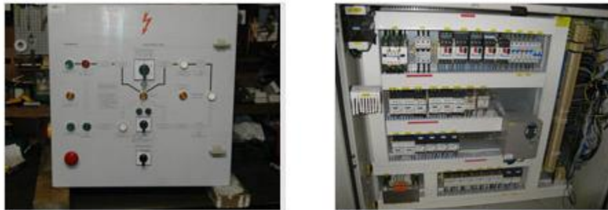
Slika 3.13: Elektro razvodni ormari [5]
