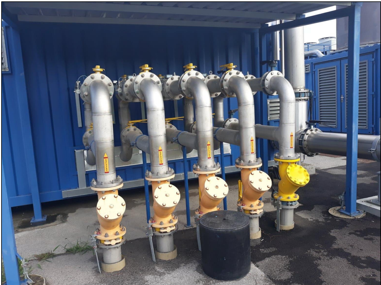
Slika 6.4. Cijevi prihvata plina koje dovode plin sa same mreže
