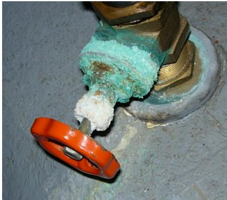
Slika 1.10 Selektivna korozija ventila [14]
