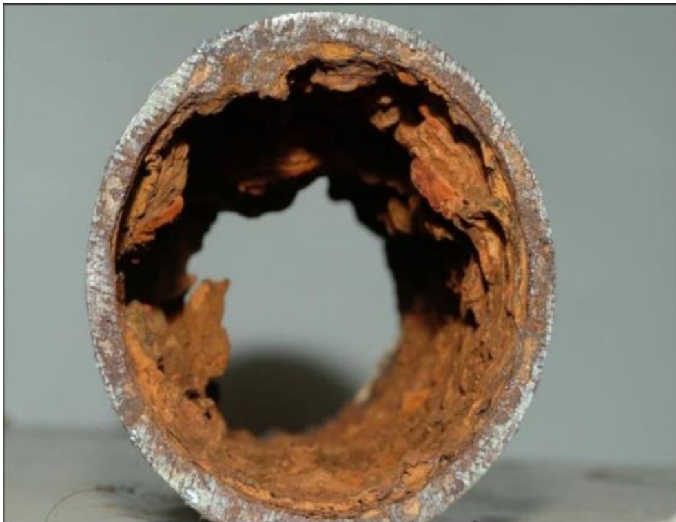
Slika 1.2 Kemijska korozija u cijevima [8]
