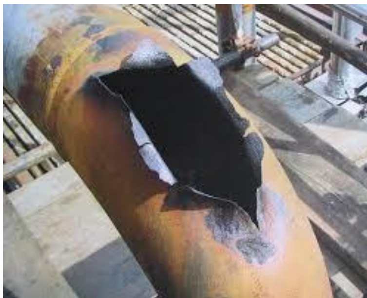
Slika 1.11 Erozijsko korozijsko oštećenje cjevovoda za transport nafte [13]
