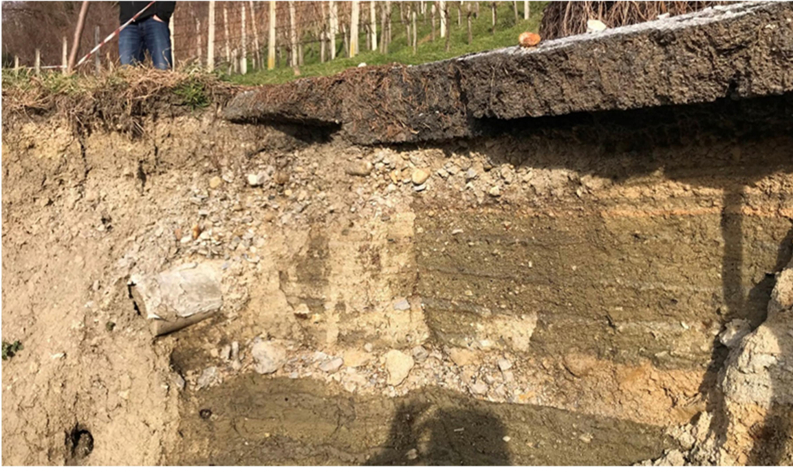
Slika 10. Izlaz cijevi u tijelo klizišta (cijev zaštopana)
