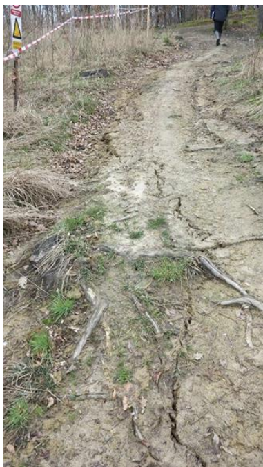
Slika 4.5. Vlačna pukotina uz čeonu rub glinokopa [1]
