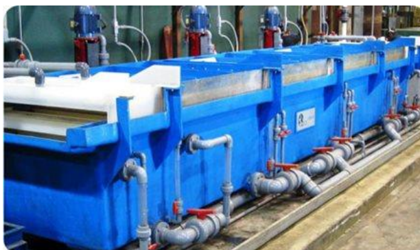
Slika 43.: Postrojenje za dekapiranje [36]
