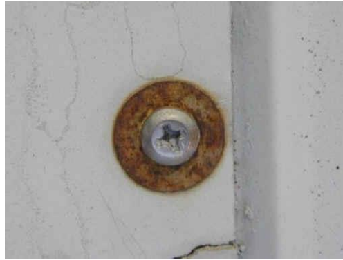
Slika 9.: Primjer kontaktne korozije [8]
