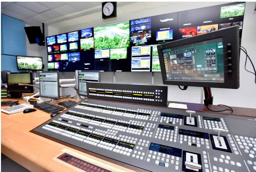
Slika 3. Soba za montažu na Hrvatskoj radioteleviziji (HRT)
