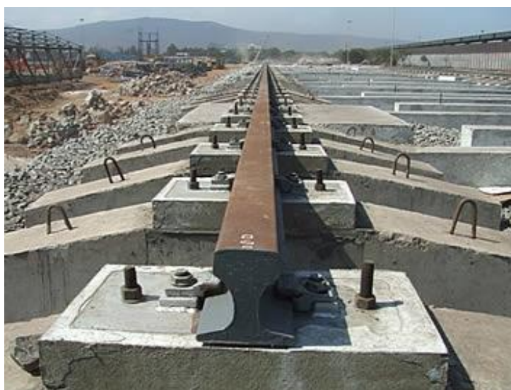
Slika 3.7. Tračnica kranske staze, Izvor: httpm.sincholdrail.cominfocrane-rail-installation_19583596.html
