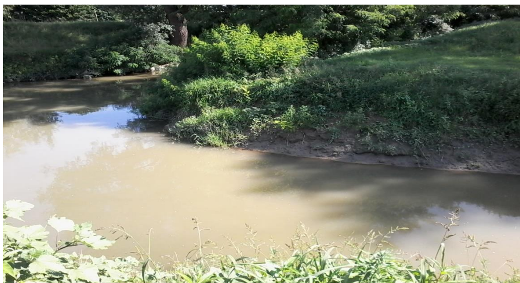
Slika 3.3. Ušće sabirnog kanala gdje je došlo do urušavanja obale u korito[8]
