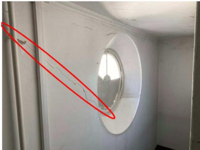
Slika 5.51. - Pukotine po vanjskim zidovima stubišta
