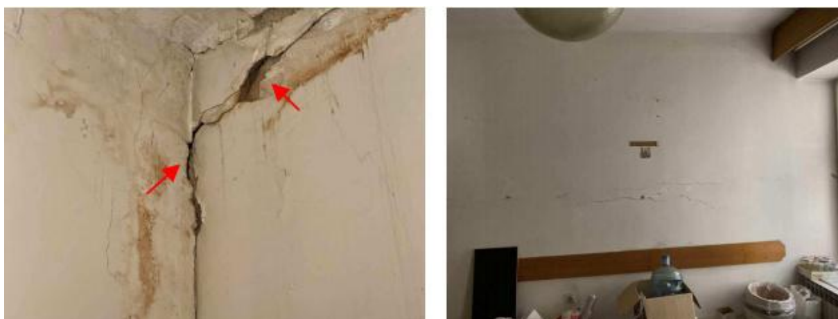
Slika 5.41. - Pukotine većeg karaktera
