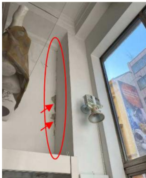
Slika 5.5. - Indikativna vertikalna pukotina na krajnjem istočnom zidu
