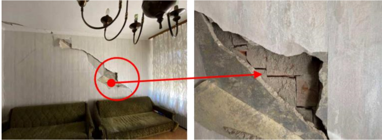
Slika 5.26. - Dijagonalna pukotina na pregradnom zidu
