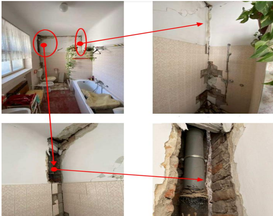
Slika 5.22. - Pukotinsko oštećenje te lom sjeveroistočnog kuta zgrade
