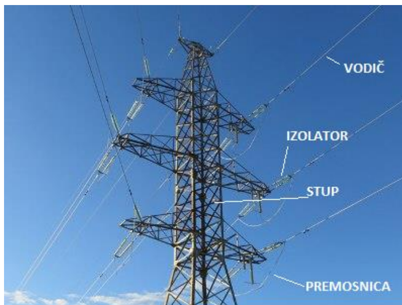
Slika 3.11 Stup prijenosne mreže – čelični rešetkasti nosač
