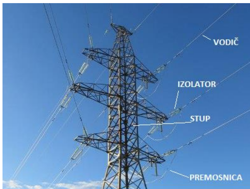
Slika 3.11 Stup prijenosne mreže – čelični rešetkasti nosač
