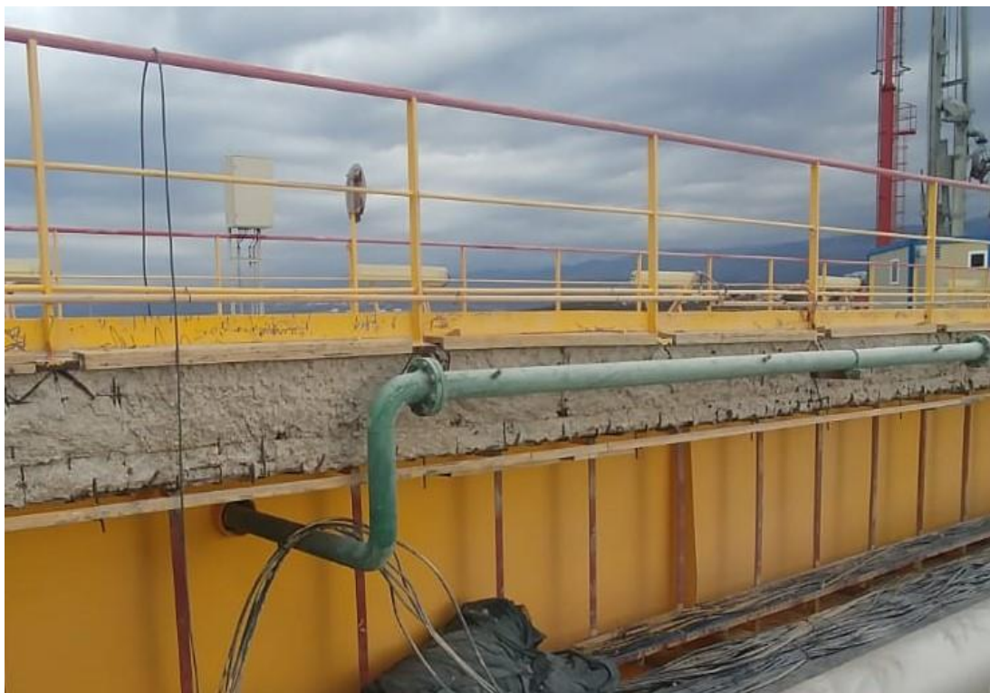
Slika 10. Oštećenje rasponske konstrukcije mosta u Janafu u Omišlju
