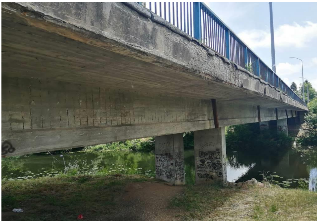
Slika 14. Oštećenja na mostu Gospić
