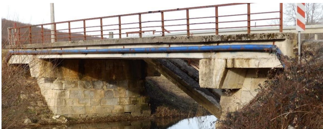
Slika 38. Zatečeno stanje mosta prije sanacijskih radova s vidljivim srušenim rubnim nosačem kao posljedicom ratne štete u Domovinskom ratu
