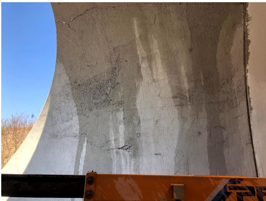
Slika 15. Oštećenja tunelske obloge
