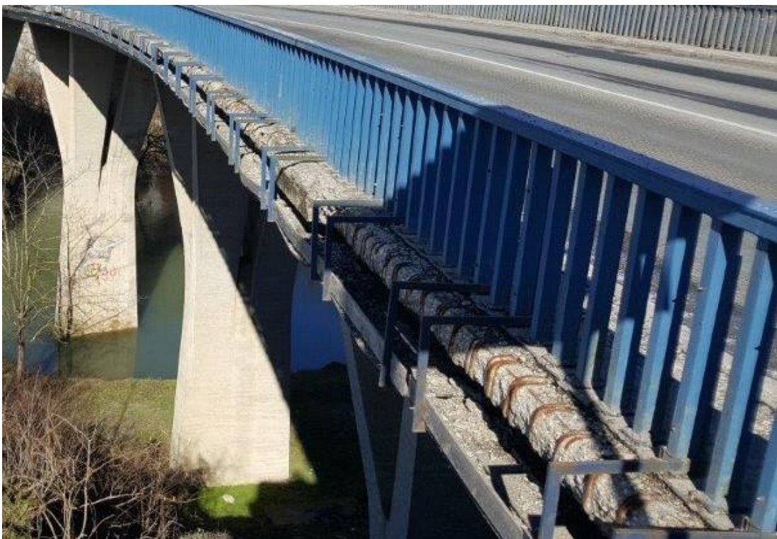
Slika 13. Oštećenje konzole hodnika mosta Slunj
