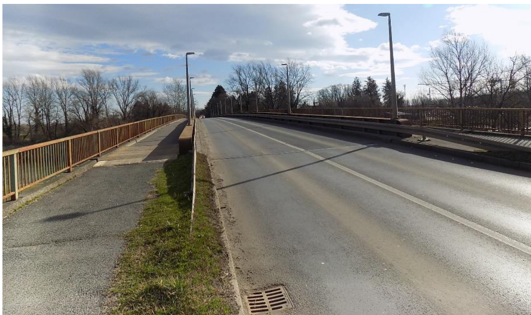
Slika 62. Zatečeno stanje mosta prije izvedbe sanacijskih radova
