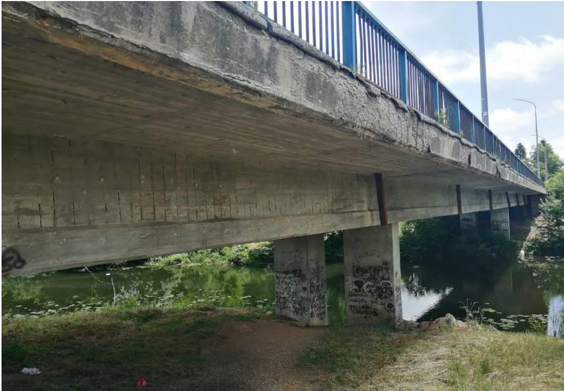
Slika 14. Oštećenja na mostu Gospić
