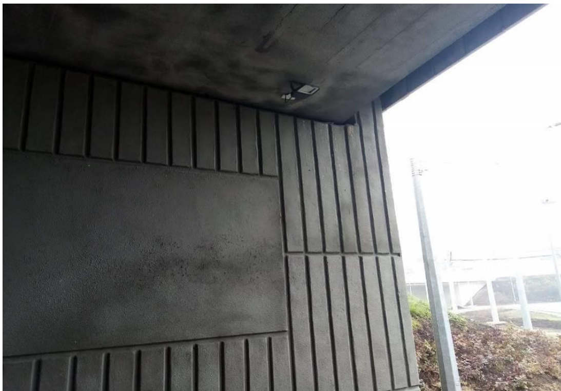
Slika 35. Kruti premaz/mort na prsnom zidu upornjaka
