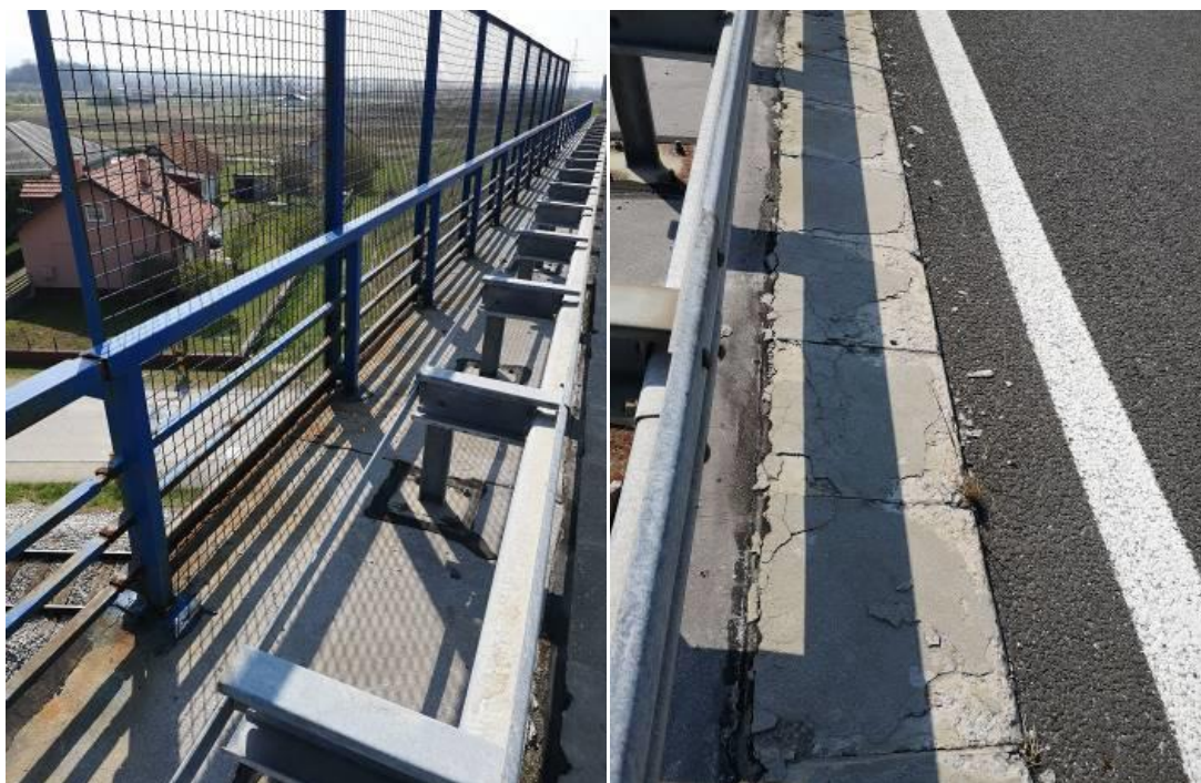
Slika 74. Oštećenja ograde, hodnika i rubnjaka nadvožnjaka
